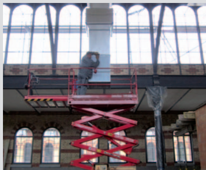
Colt Techniker bei der Installation der Belüftungs-/ Beheizungsanlagen – Die Anlagen fördern ein maximales Gesamtvolumen von 72.000 m 3 /h.
