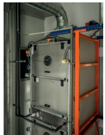
... die bei der Produktion durch die Prozesswärme entsteht.
