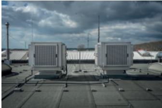
... es ermöglicht, die Abwärme aus den Produktionsprozessen zu nutzen.
